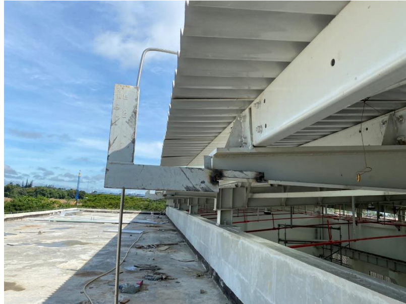
Gambar 5. 8 Perubahan Pemasangan Gutter di Lapangan
