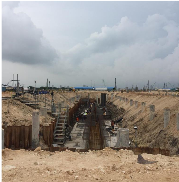
Gambar 6. 2 Penggunaan SSP pada RO Building
