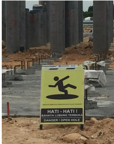
Gambar 4. 21 Peringatan Lubang Terbuka
