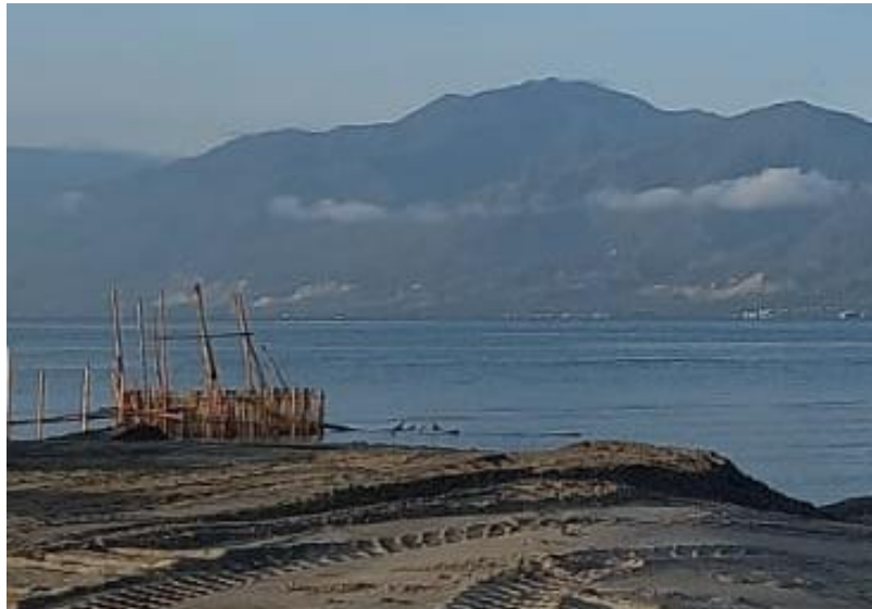
Gambar 3.13 Penggunaan Sesek Bambu yang Rusak tergerus Gelombang (Sumber: Dokumentasi Pribadi, 2022)
