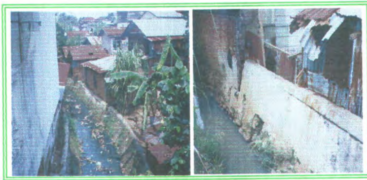
Gambar 5.41 Kondisi Saluran Drainase di Wilayah Pasar Sumber : hasil pengamatan, 2004
