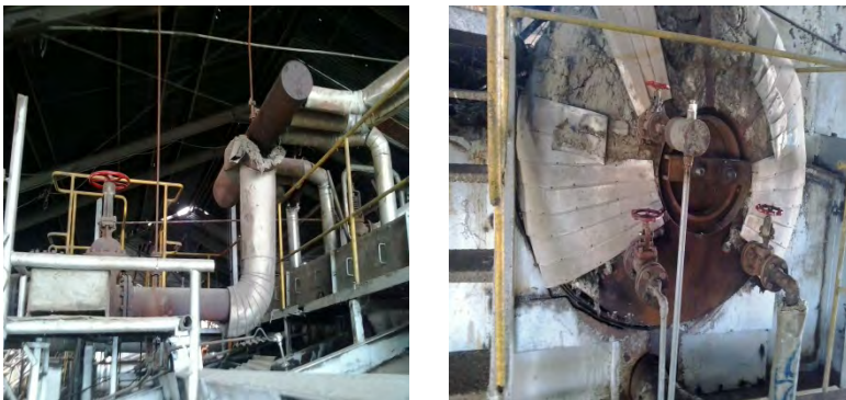
Gambar 4.5. Kondisi ducting untuk distribusi uap dari ketel
