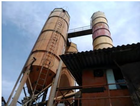
Gambar 3.3 Tempat penyimpanan fly ash di PT. Surya Beton Indonesia
