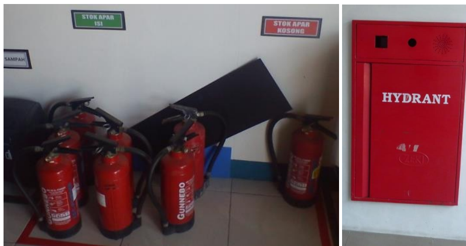
Gambar. Gas CO 2 sebagai pemadaman aktif dan Hydrant sebagai pemadaman pasif
