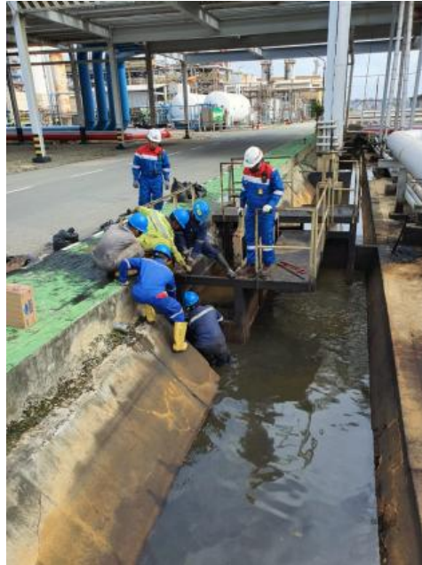
Gambar 4.1 Maintenance pada valve sekitar area primary unit .
