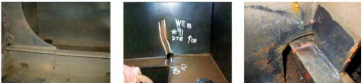
Gambar 2.24 Retak pada daerah end connection , diambil dari http://www.slideshare.net/ismelkov/dnv-hull-structure-course
