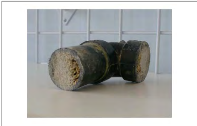
Gambar 2.4 : Sumbatan akibat kontaminan mineral yang terkandung dalam air
