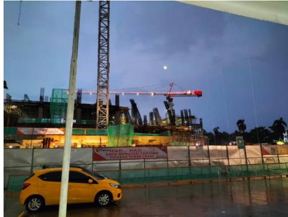
Gambar 4.48 Kolom Miring Akibat Hujan Badai
