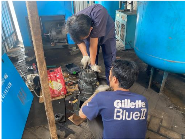
Gambar 4.56 Kegiatan Maintenance Kompresor yang tidak bisa diselesaikan karena tidak mengetahui troubleshooting yang harus dilakukan
