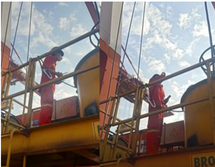
Pelumasan pada Cable Basket Spreader Bromma SSX40 Container Crane
