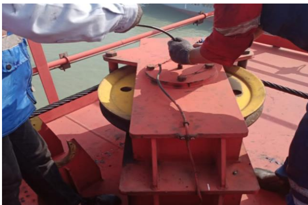
Greasing pada titik nipple grease menggunakan grease gun yang berada pada sheave sistem Trim , List , dan Skew
