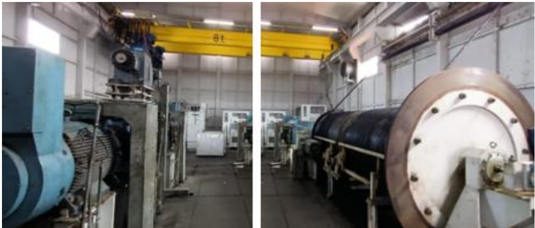
Gambar 4. 25 Machinery Room tampak dalam pada CC 04
