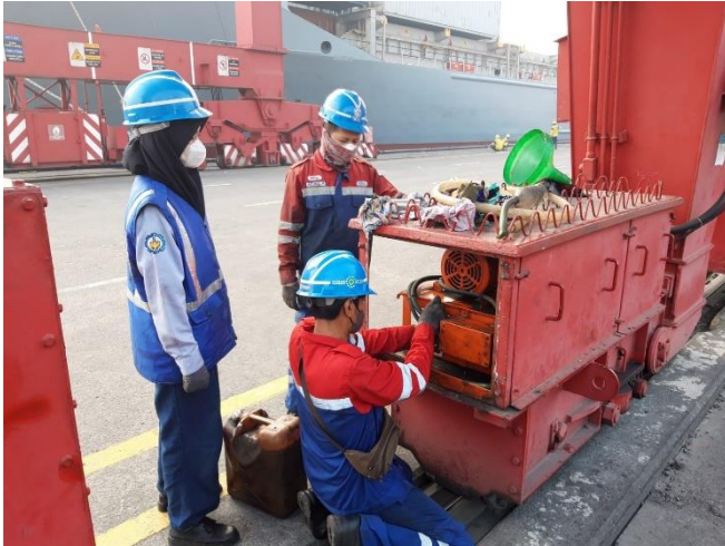
Pengisian hydraulic oil pada power pack gantry container crane 01
