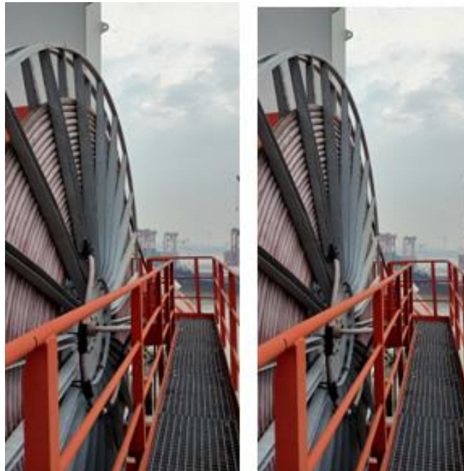
Gambar 4. 40 Cabel Rel pada Container Crane
