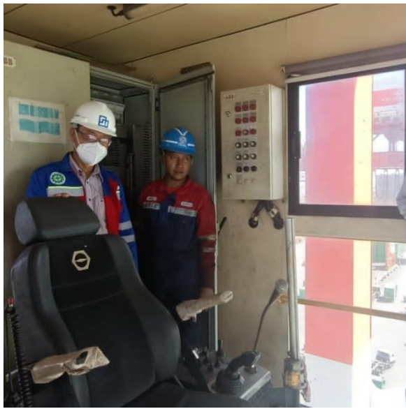
Kunjungan ke kabin operator Container Crane (CC)
