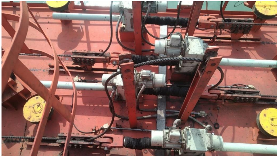
Gambar 4. 28 Trim, List, Skew (TLS) bagian depan pada Boom CC 05
