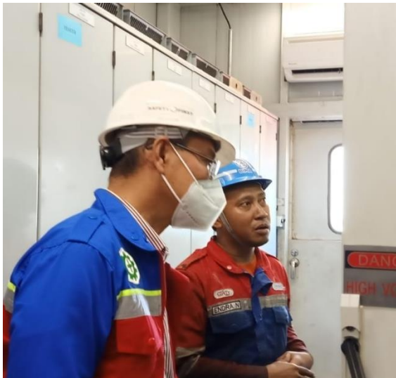
Penjelasan teknisi mengenai electrical room bersama Dosen Pembimbing (Pak Arino)
