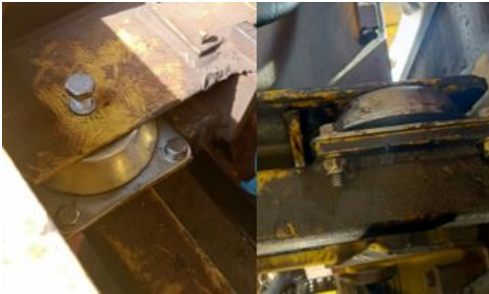
Rubber Mounting yang berjumlah 4 buah yang dipasang pada bawah Powerpack Spreader Bromma SSX40 Container Crane
