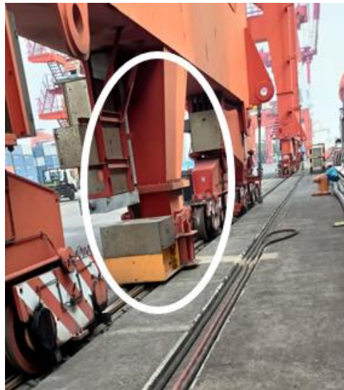
Gambar 4. 37 Rail Clamping Device pada Container Crane
