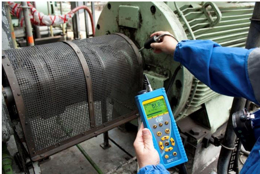
Gambar 4. 53 Vibration Monitoring pada Mesin dan flux magnetik pada motor (Sumber : Gama Semesta Konsultindo/ gamasemesta.com)
