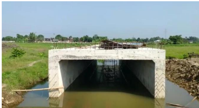
Gambar 3. 21 Genangan Yang Terjadi Akibat Hujan
