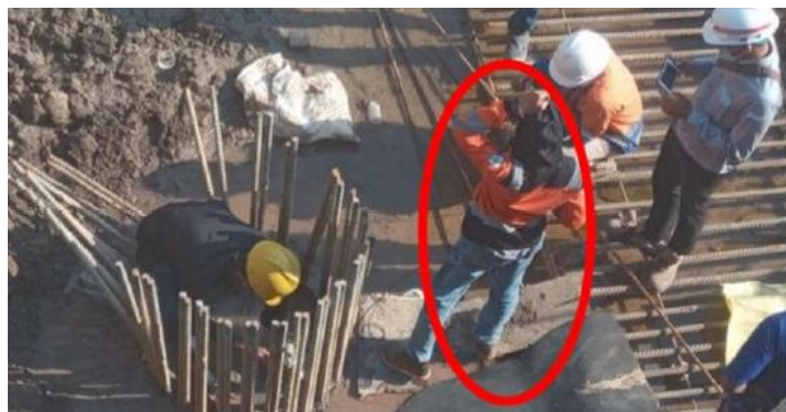
Gambar 3. 23 Pekerja Tidak Menggunakan APD Lengkap
