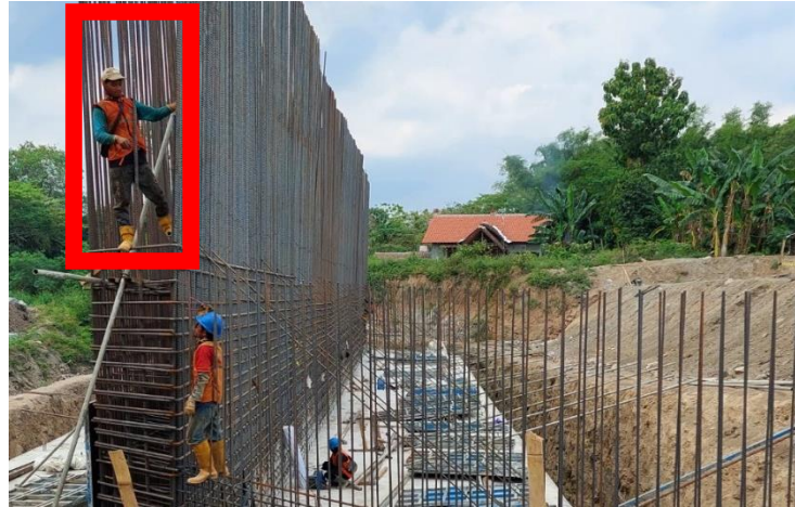
Gambar 3. 24 Pekerja Tidak Menggunakan APD Lengkap
