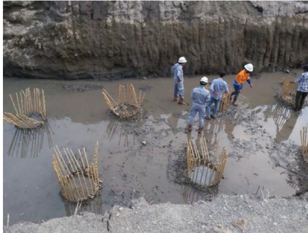
Gambar 3. 22 Genangan Yang Terjadi Akibat Hujan
