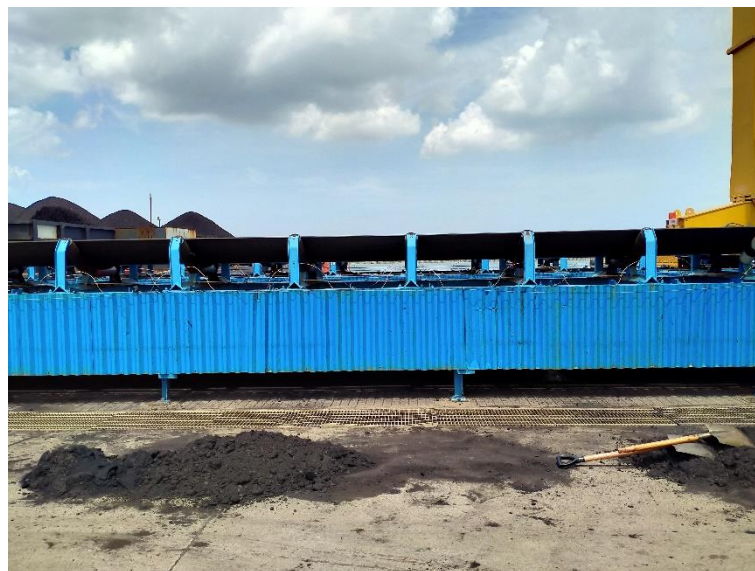
Gambar 4.17 Belt Conveyor C1A dan C1B
