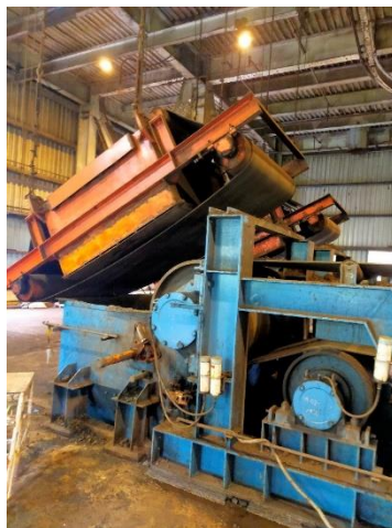
Gambar 4.20 Magnetic Separator pada Transfer Tower
