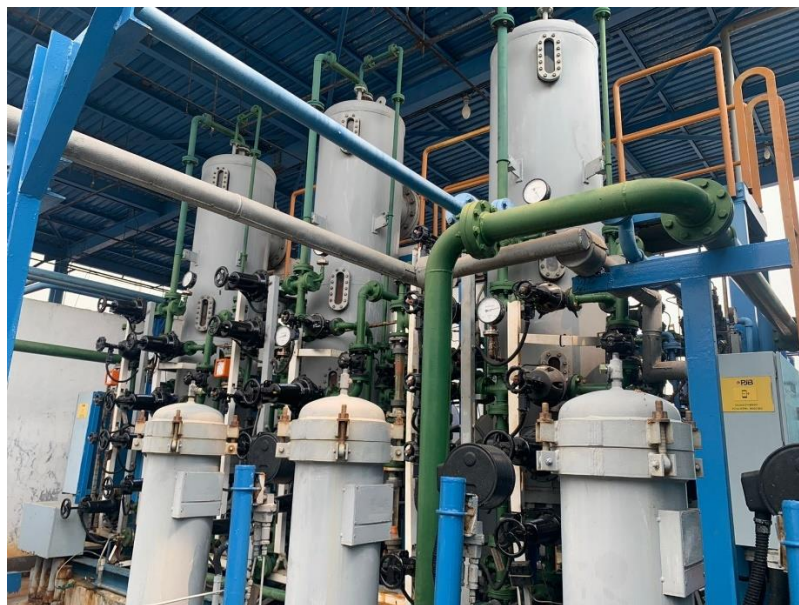
Gambar 4.16 Pre Filter dan Mix Bed pada WTP UP Gresik
