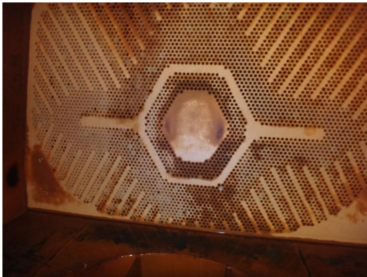
Gambar 4.42 Permukaan Tube Inlet dan Outlet
