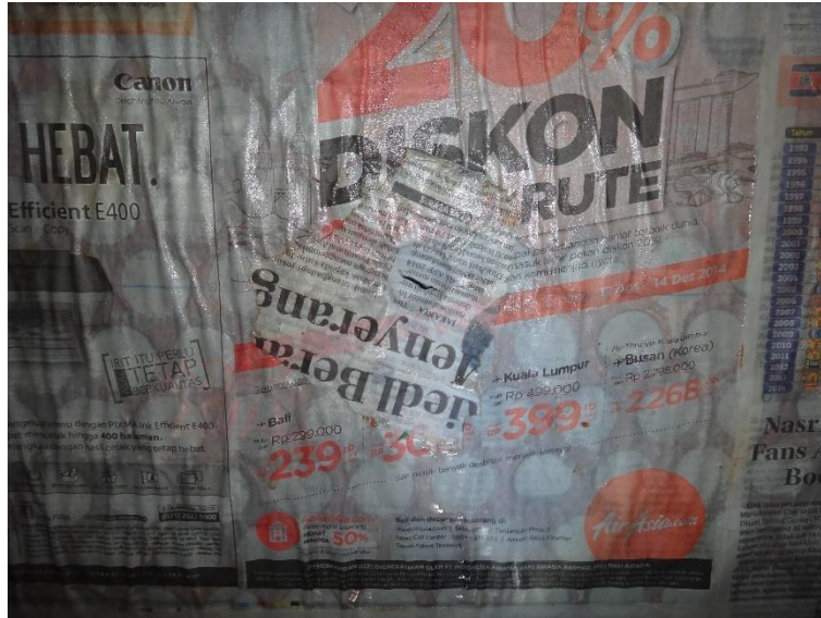
Gambar 4.43 Permukaan Tube Inlet dan Outlet yang Sudah Ditutup Lembaran Koran dan Ada Lubang Karena Adanya Kebocoran
