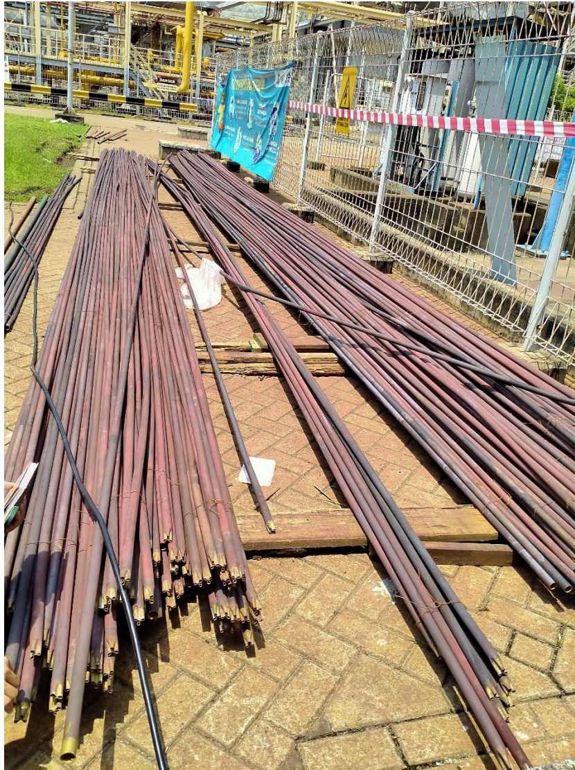
Gambar 4.46 Tube Kondensor yang Sudah Mengalami Kerusakan
