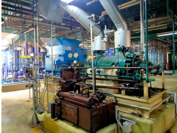
Gambar 4.10 High Pressure Boiler Feed Pump pada PLTGU
