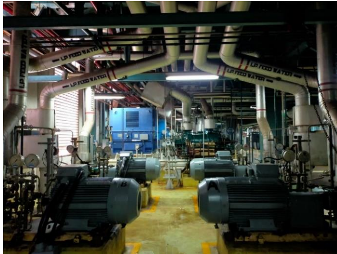
Gambar 4.9 Low Pressure Boiler Feed Pump pada PLTGU
