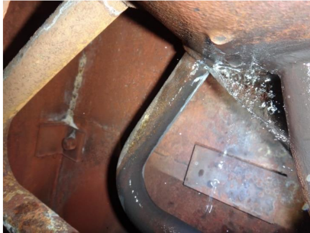
Gambar 4. 38 Kebocoran pada Tube HRSG
