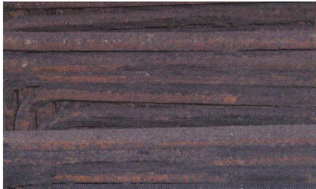
Gambar 4. 35 Kotoran-kotoran pada Fined Tube HRSG (PJB Gresik)
