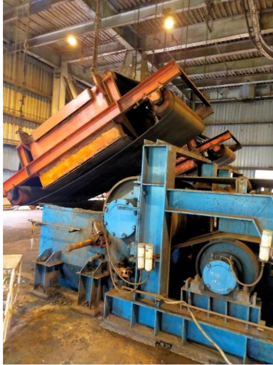
Gambar 4. 16 Magnetic Separator pada Transfer Tower
