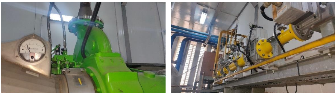
Gambar 4.11 Gas Mixer dan Saluran Gas
