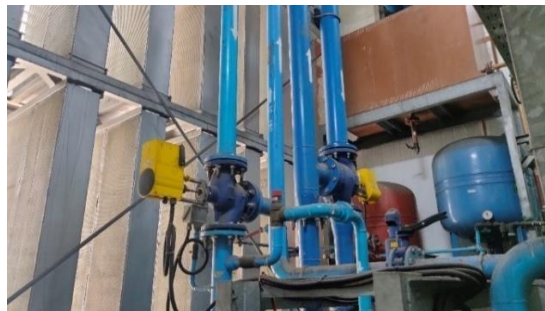
Gambar 4.17 Saluran Pipa Radiator
