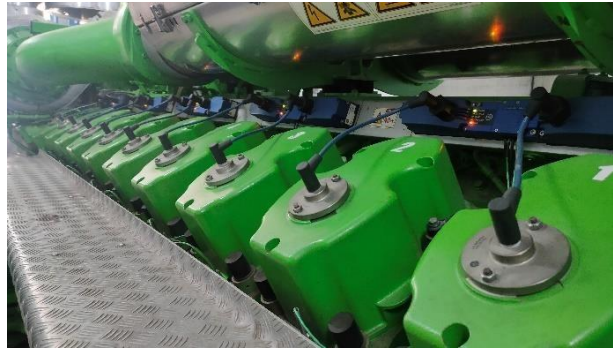
Gambar 4.10 Cylinder Pembakaran PLTMG
