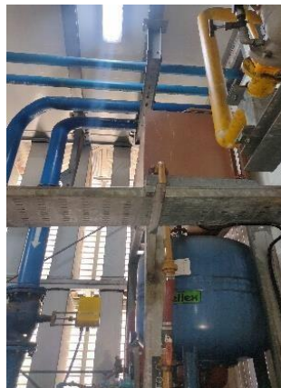
Gambar 4.15 Radiator pada PLTMG
