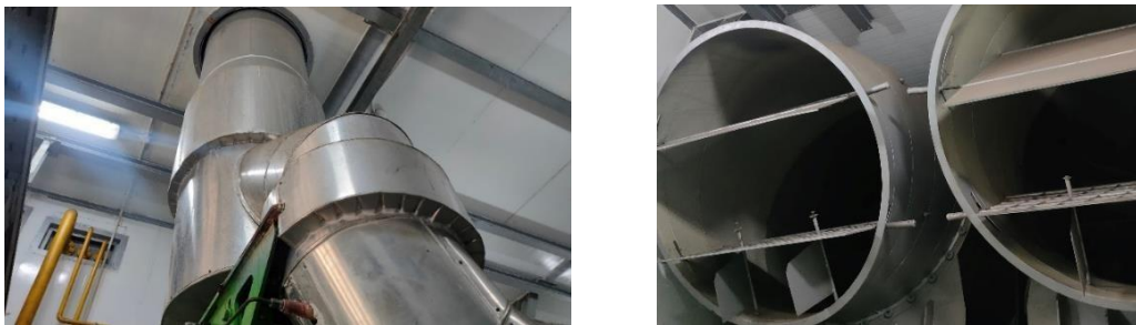
Gambar 4.18 Saluran Udara pada PLTMG
