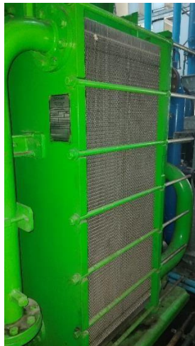
Gambar 4.6 Heat Exchanger Pada PLTMG
